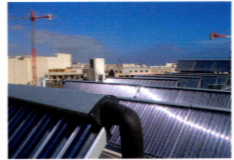
Die solare Großanlage erzielt eine solare Deckungsrate von 93 %; Damit spart der Betreiber des Hotels jährlich Energiekosten in Höhe von rund 68000 €
