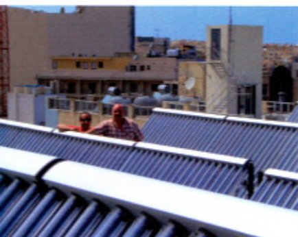
Peter Kößler (r.), bei IVT im Bereich Export für Verkauf und Technischen Support verantwortlich, hat den Bau der solaren Großanlage von der Planung bis zur Inbetriebnahme begleitet
